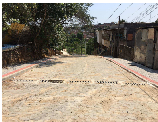
Foto 41 - Rede de drenagem em série danificada, via pavimentada e passeios.
