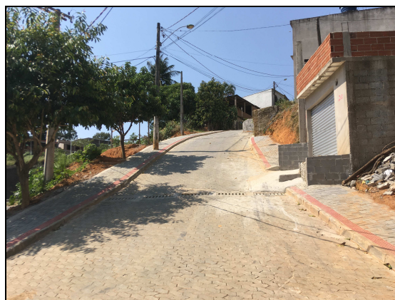
Foto 35 - Rua pavimentada e calçadas obstruídas.
